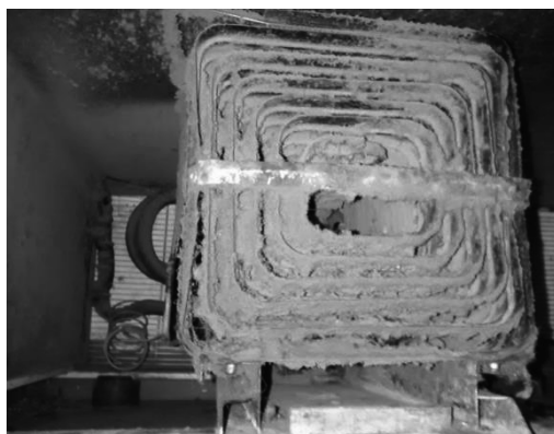
FIGURA 7.3 CONDENSADOR DE REFRIGERADOR SIN MANTENIMIENTO
