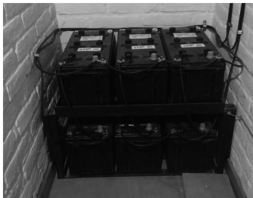
FIGURA 7.6 BANCO DE BATERÍAS PARA SFV TIPO ISLA
